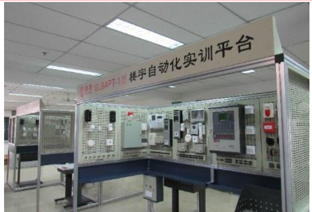
楼宇自动化实训室
