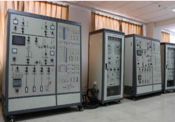
工厂供配电实训室
